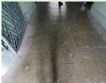
地坪因沉陷產生裂縫
