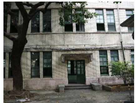
出入口與立面裝飾損壞髒污
