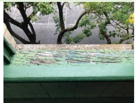
木門窗櫃體劣化和剝裂
