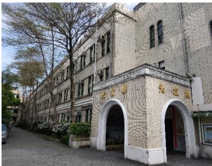
外牆面磚不一且劣化有植生
