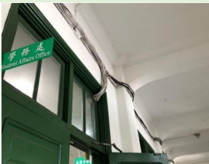
室內走道管線雜亂
