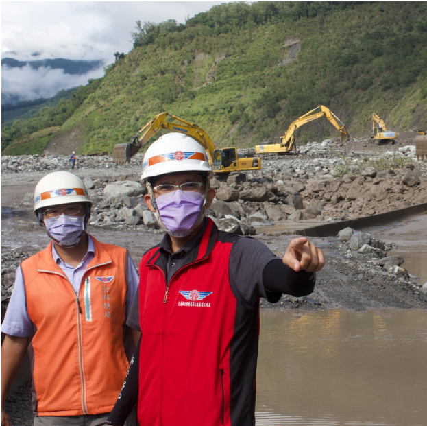
▲ 明霸克露橋受損指揮搶災工作。(右，左為交通部公路局南區養護工程分局王副分局長慶雄)
